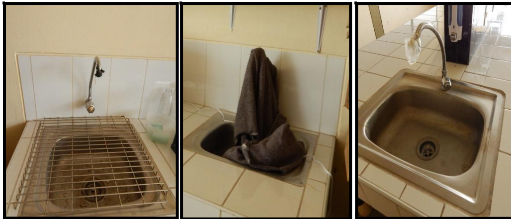
Figura 14. Grifos malogrados en el Pabellón de los Laboratorios de la Facultad de Ciencias Biológicas. Setiembre a diciembre 2015.
