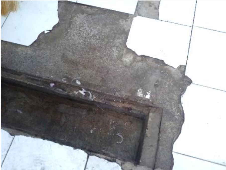
Figura 10. Canaletas despostilladas con falta de limpieza y mantenimiento en el área de proceso.
