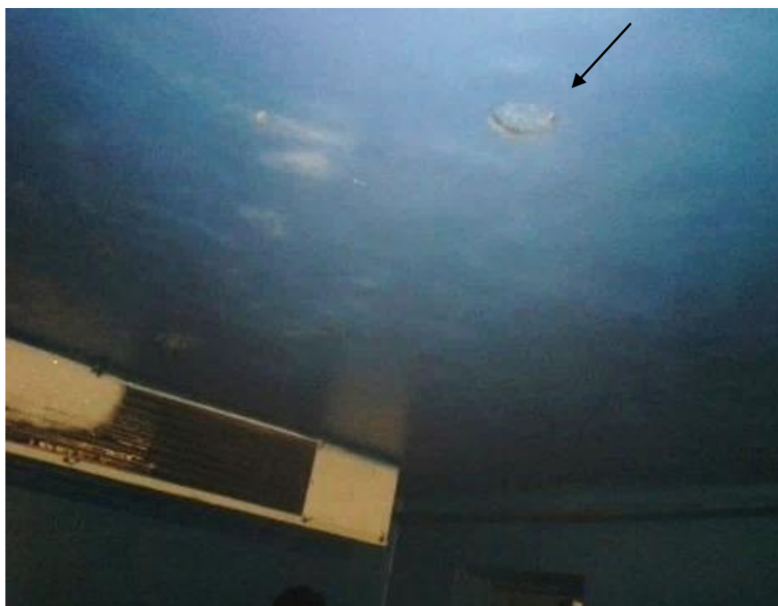
Figura 8. Falta de luminaria en la cámara de frío perteneciente al almacén de productos frescos.
