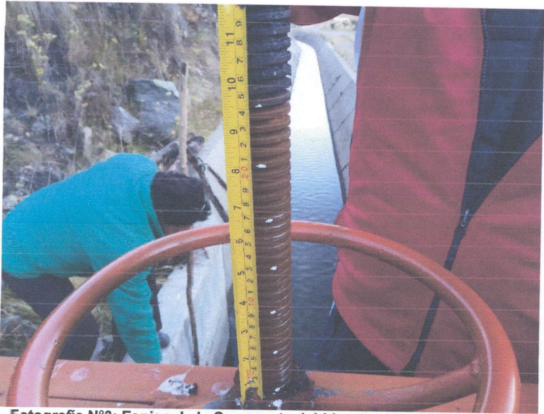
Fotografía N°3: Espiga de la Compuerta debidamente señalizado para su operación.
