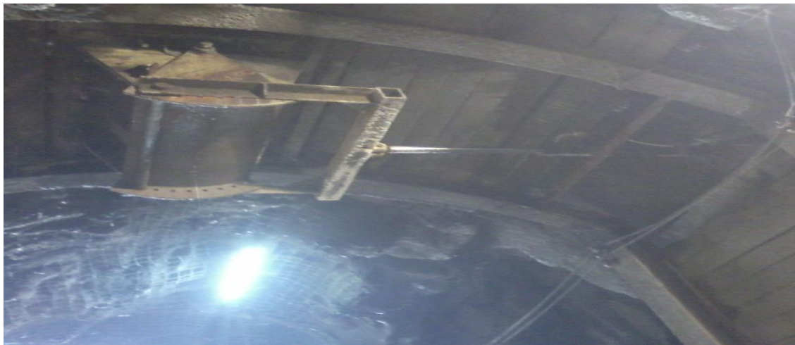
Fotografía 15: Vista de la compuerta de descarga del chut hidráulico
