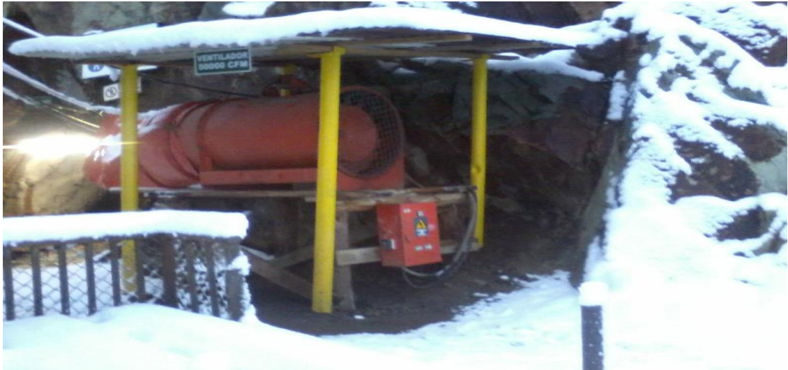
Fotografía 26: Vista de la Ventiladora Axial de emergencia
