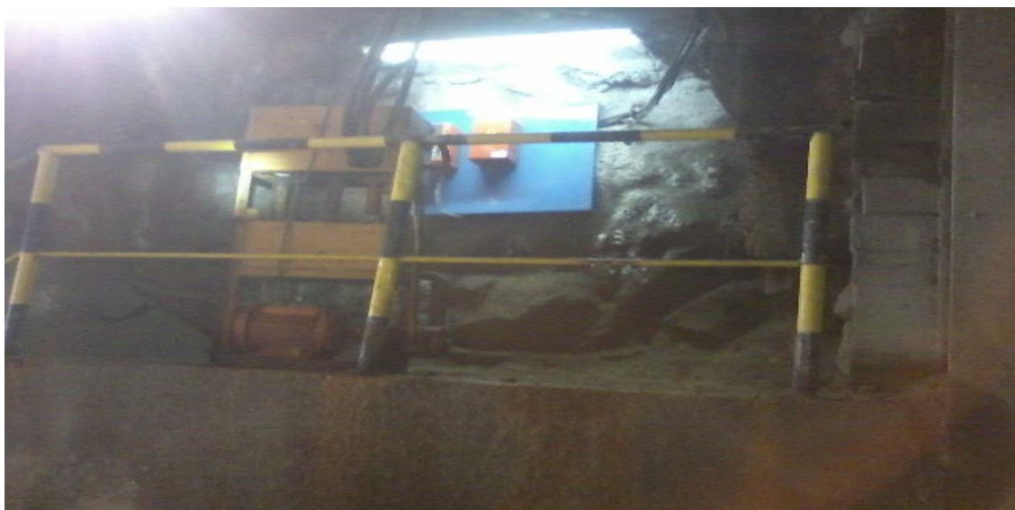
Fotografía 16: Comando para abrir y cerrar la compuerta del chut hidráulico
