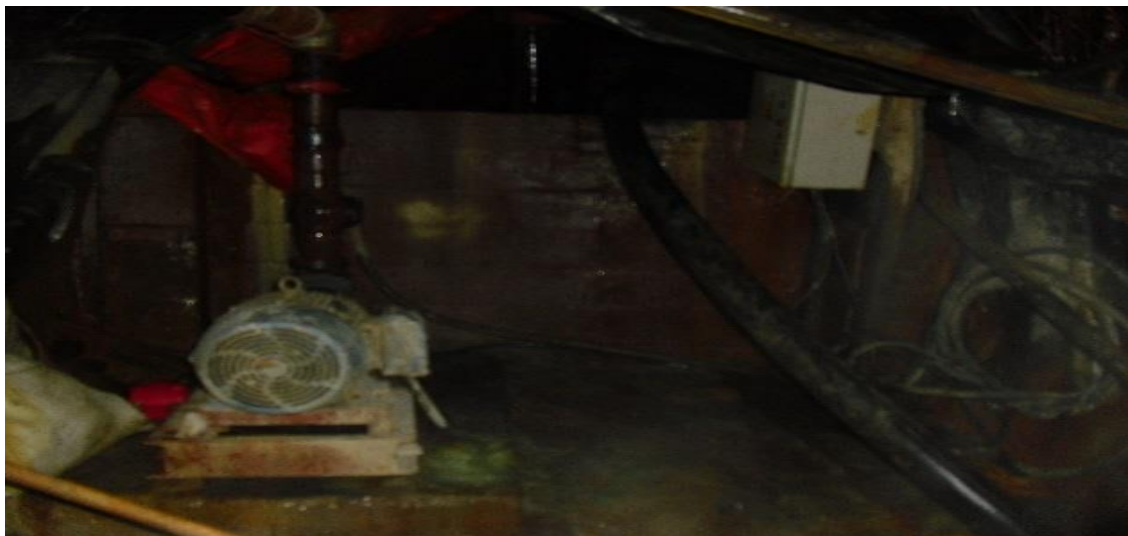
Fotografía 25: Vista de la poza de bombeo con la motobomba automática
