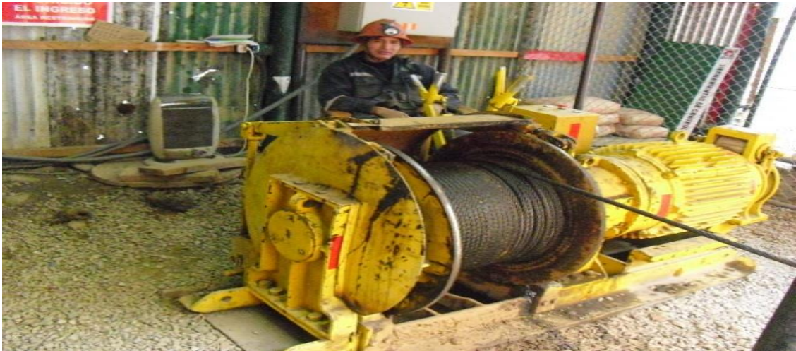
Fotografía 23: vista del comando y cableado del skip
