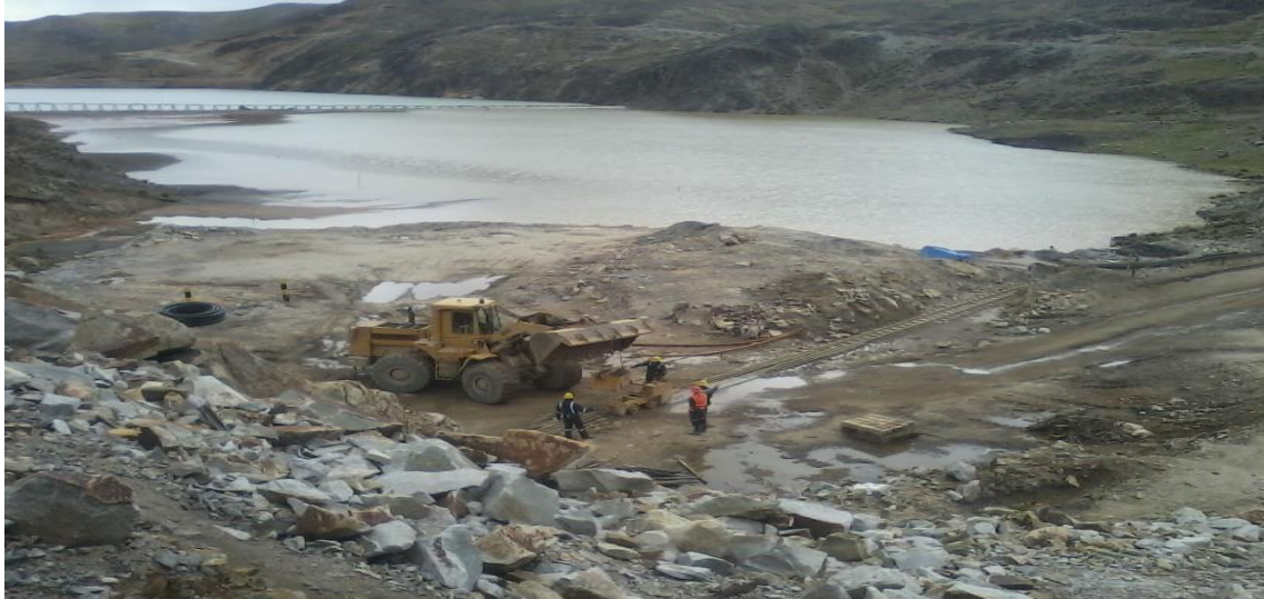
Fotografía 14: Vista de la colocación de locomotora en la riel de la vía con cargador frontal
