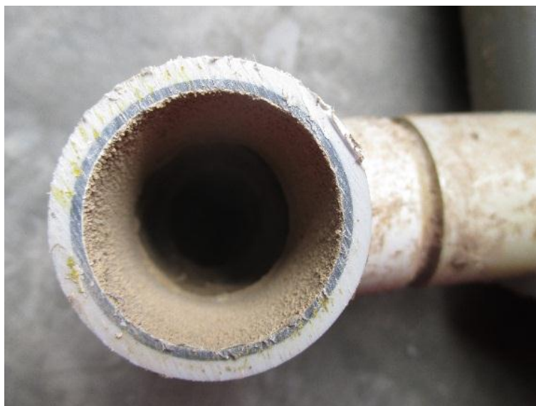
Figura 10. Obstrucción de la tubería interior
