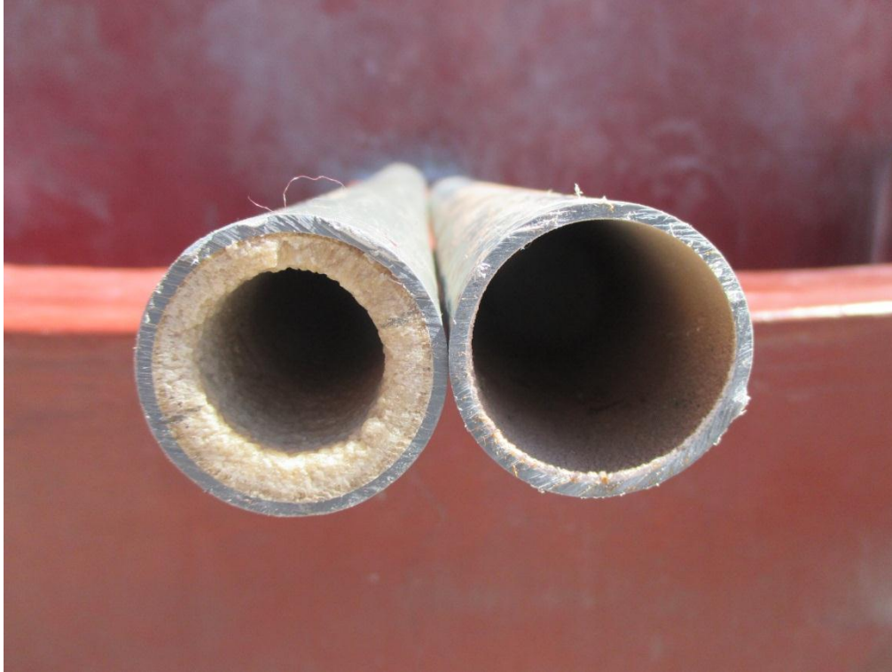
Foto N° 09. Obstrucción de tubería en 3 años en la localidad de pitahua. tubería lado izquierdo ubicada en la línea de distribución ( e=5.00 mm) y tubería de lado derecho en línea de conducción ( e=1.00 mm)
