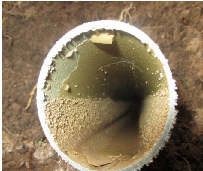
Figura 14. Interior de la tubería con formación de sarro
