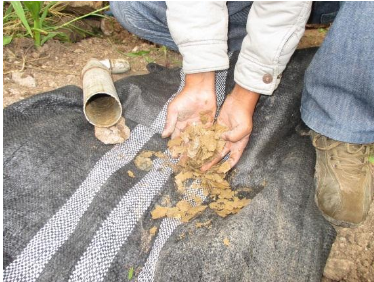
Figura 9. Restos de sarro obstruidos en la tubería
