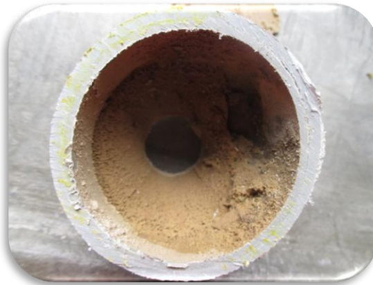
Figura 7. Tubería obstruida en un tiempo de 8 meses Fuente: elaboración propia, (2014)
