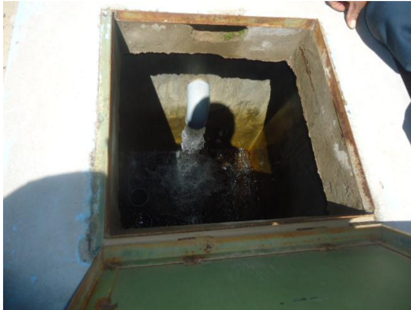
Figura 3. 34: Presencia de óxido en cámara rompe presión
