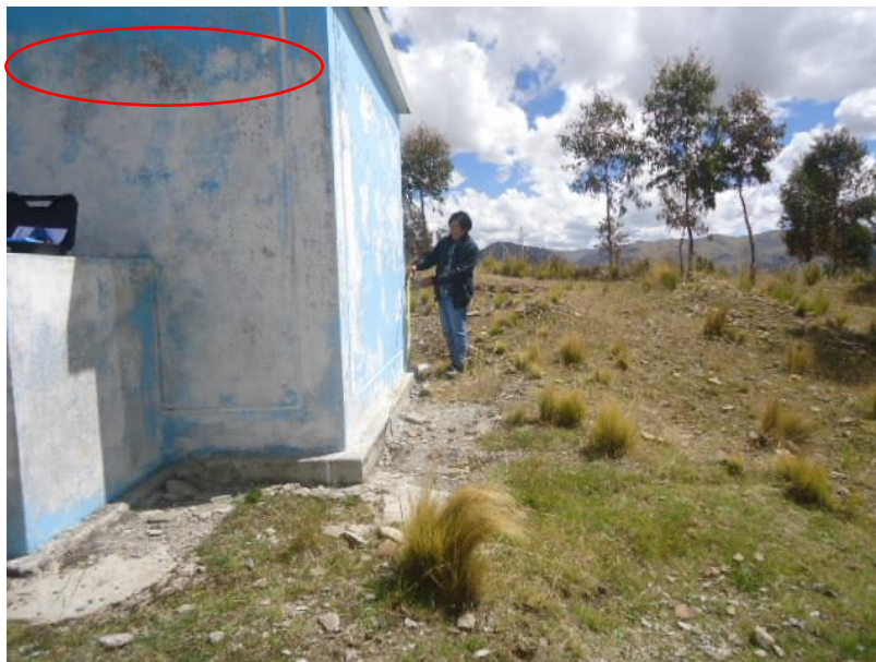
Figura 3. 35: En reservorio se puede observar filtraciones en la pared
