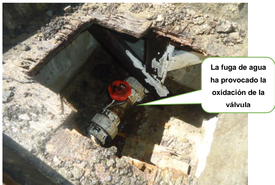
Figura 3. 32: La válvula presenta fugas y se aprecia madera hongueada
