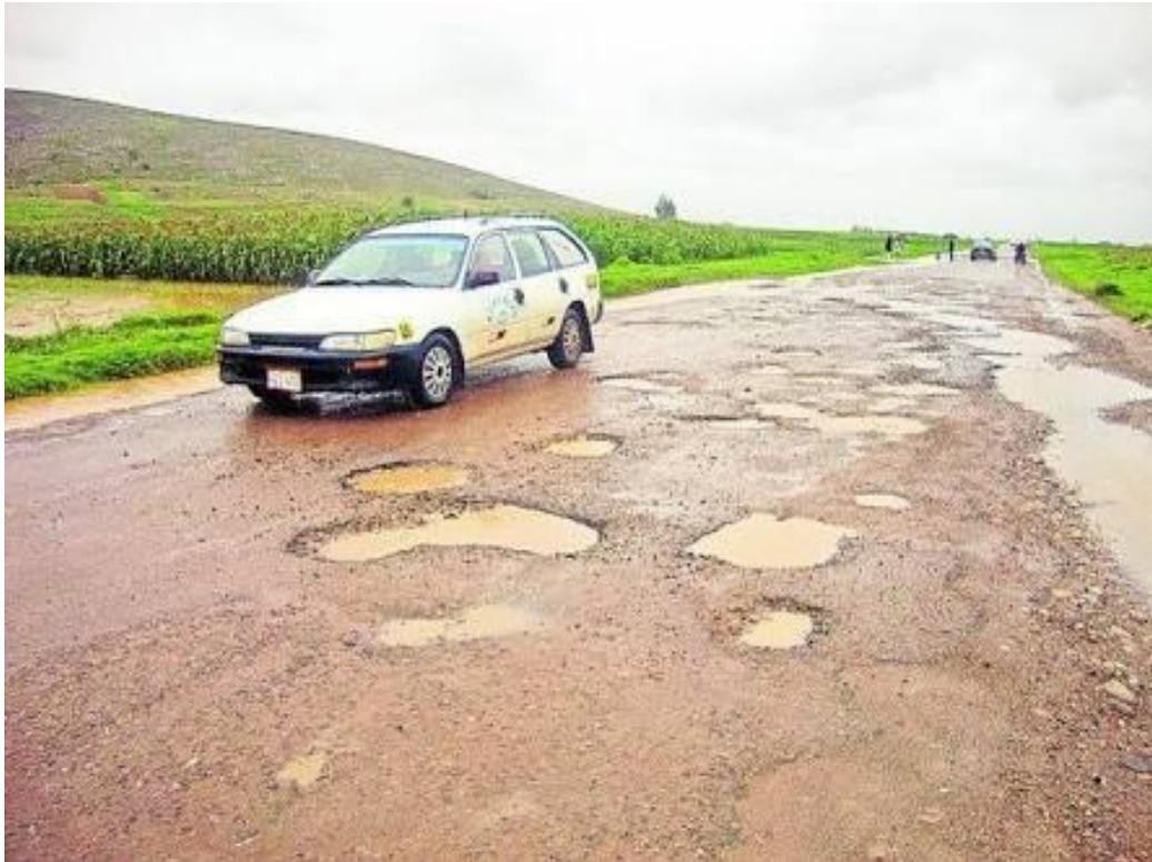
Figura 29: Carretera en mal estado, alturas de Santa María de Chicmo
