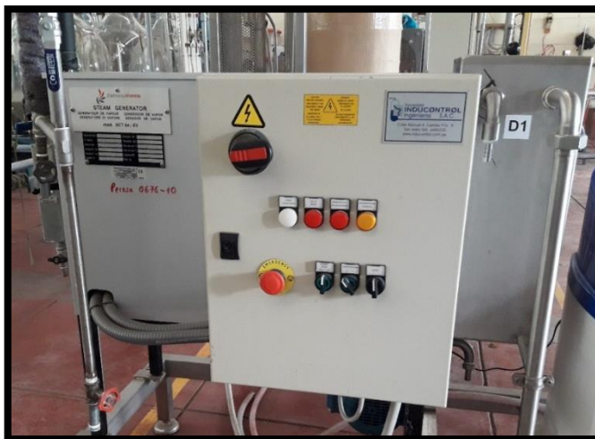
Figura 11. Generador de vapor del equipo de extracción de aceites esenciales
