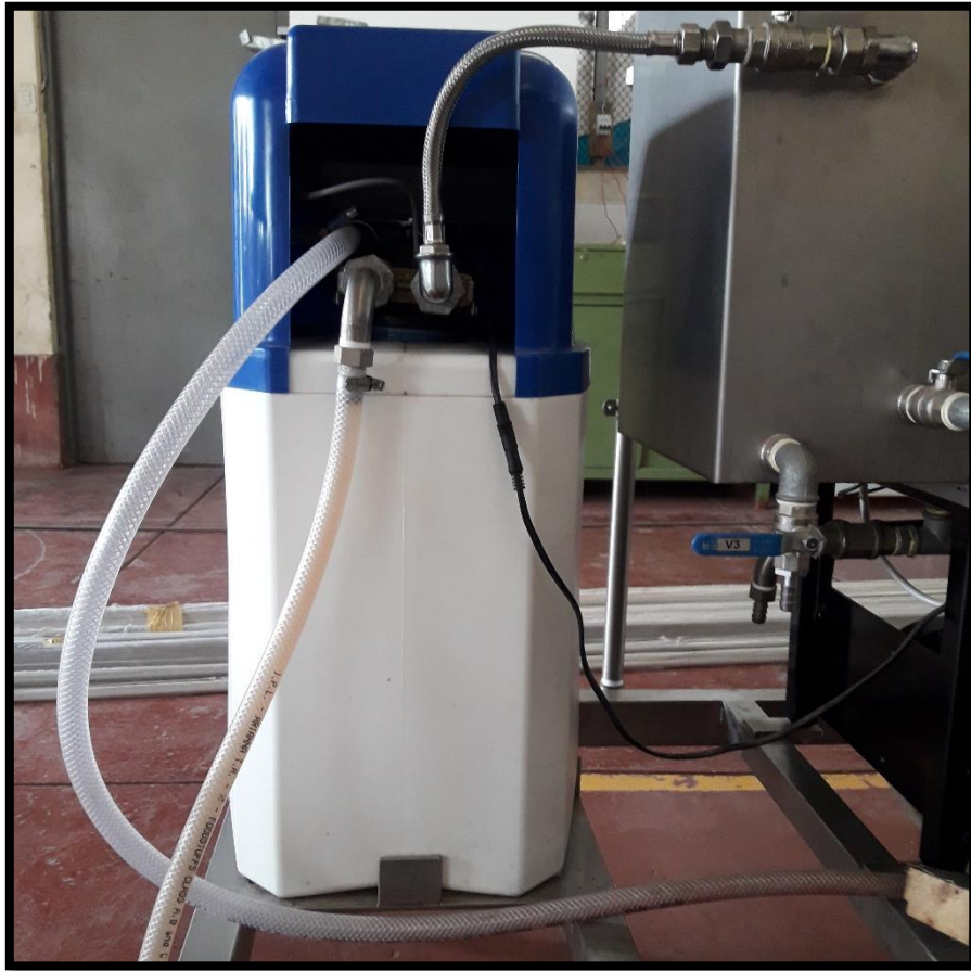
Figura 15. Suavizador de agua que se suministra al generador de vapor
