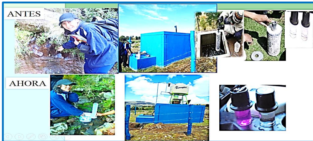
Fotografía 03. Estado anterior del sistema de cloración por difusión y el estado actual del sistema de cloración por goteo.
