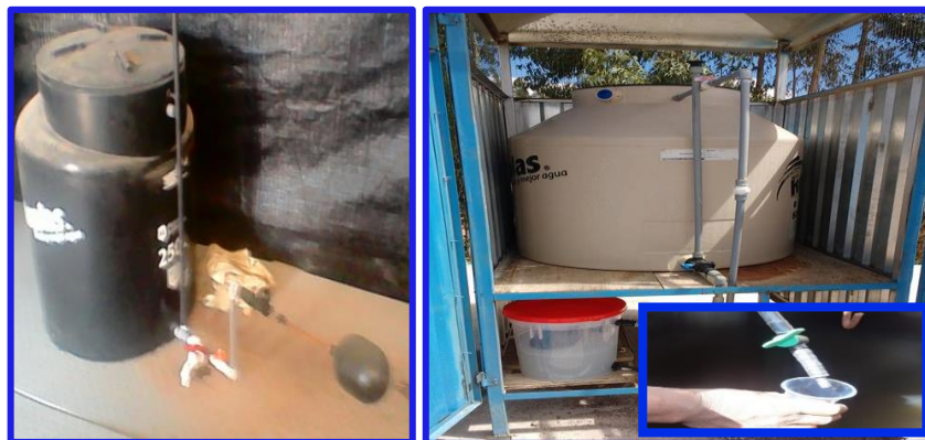
Figura 2.20 Modelo de cloración por goteo del Ministerio de Vivienda Construcción y Saneamiento (MVCS).
