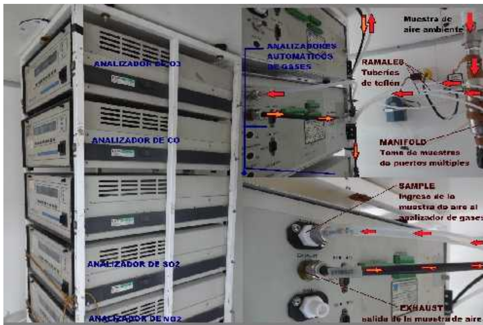
ANEXO N° 22: Conexión de los analizadores automáticos de gases al Manifold mediante tuberías de teflón, en el interior del SHELTER.
