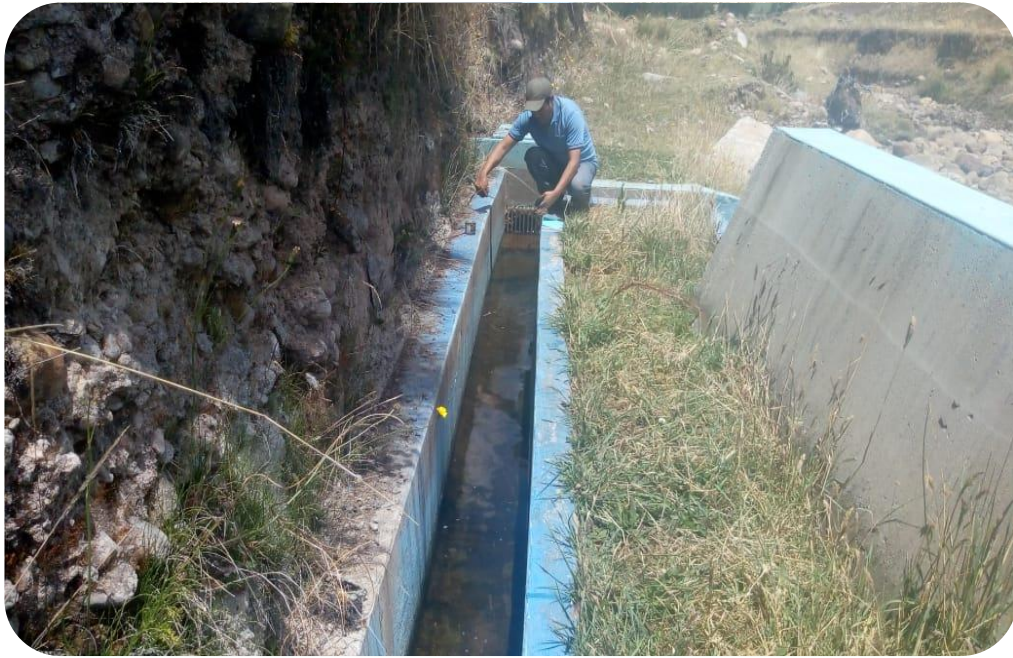
Vista 01: Medición de canal de concreto de ingreso, a la tubería en bocatoma
