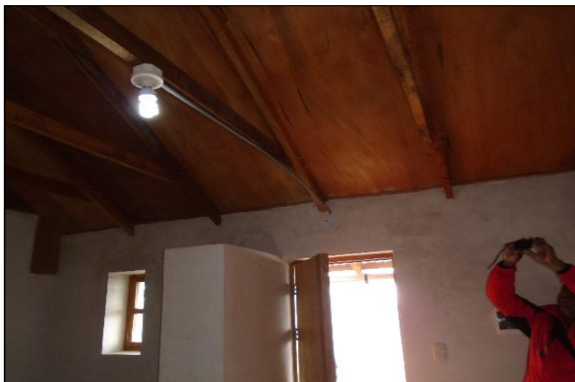
Figura 3.46. Prueba de energía eléctrica vivienda 12
