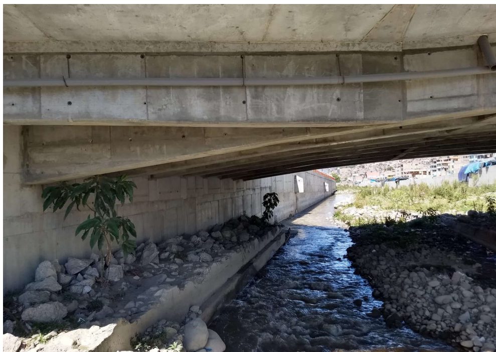
Afectación de la estructura del puente Poshcota
