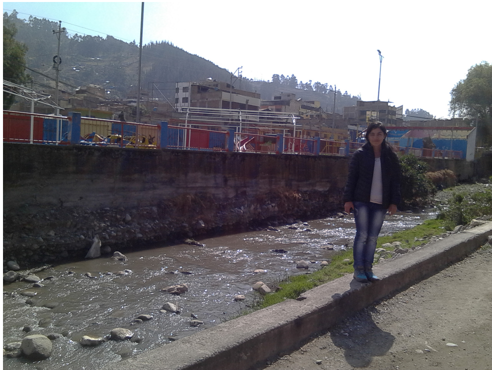
Vista panorámica de la socavación en muros de encauzamiento
