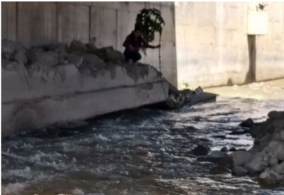
Inundación en el estribo izquierdo del puente Poshcota
