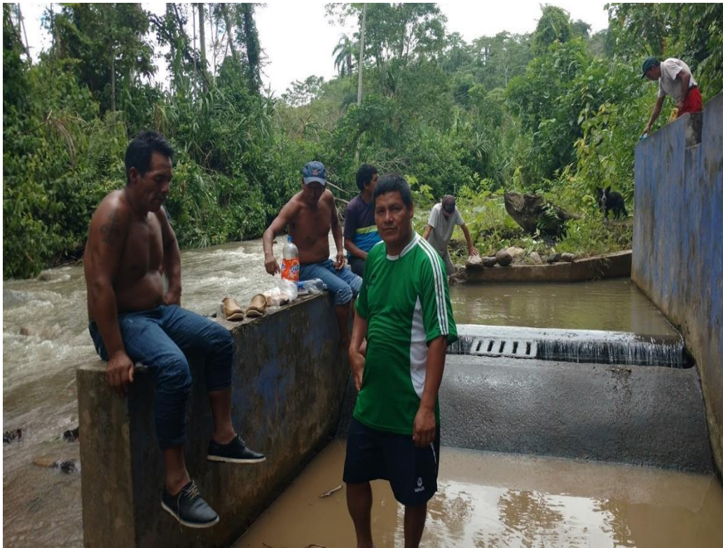
Fotografía 11. Captación tipo barraje en mal estado.
