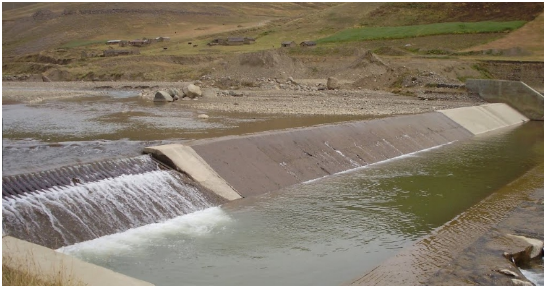
Figura 2.5: Captación de Fondo
