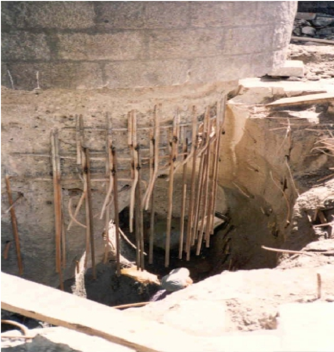
Figura 2.9: Erosión local en el pilar 02
