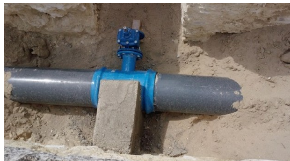
Figura C.7: Vista de una conexión domiciliaria .
