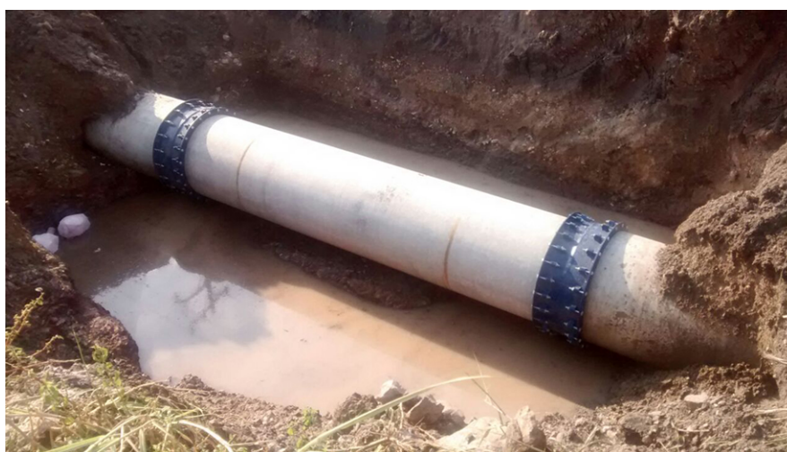
Figura C.4: Vista de un tramo de tubería de agua potable rehabilitada.
