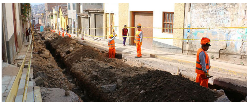
Figura C.3: Excavaciones cercanas de líneas de tuberías de conducción de agua potable.
