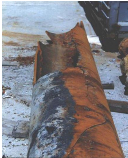
Figura 2.1: Fallo por corrosión en tubería de fundición dúctil(Paraa Toro, 2013).
