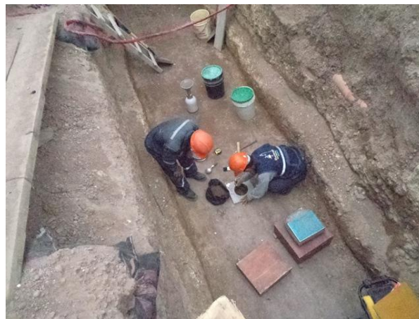
Figura C.9: Excavaciones que afectan las líneas de tubería de una red de agua potable.
