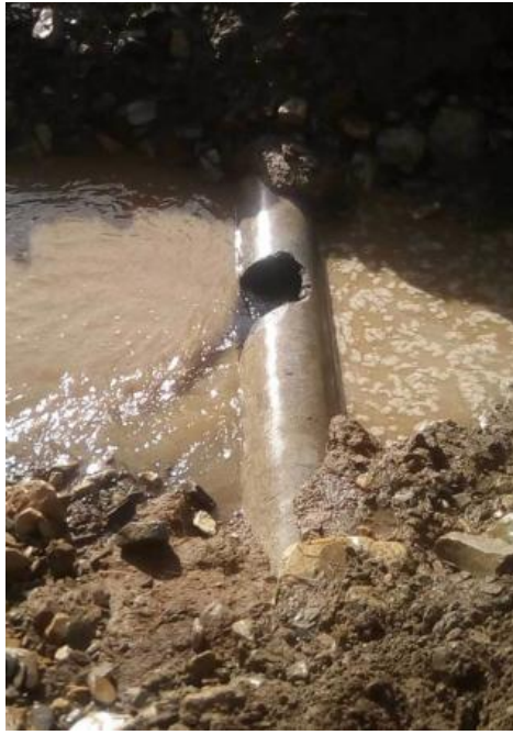
Figura C.10: Instantes donde ocurre una rotura de una tubería de agua potable.
