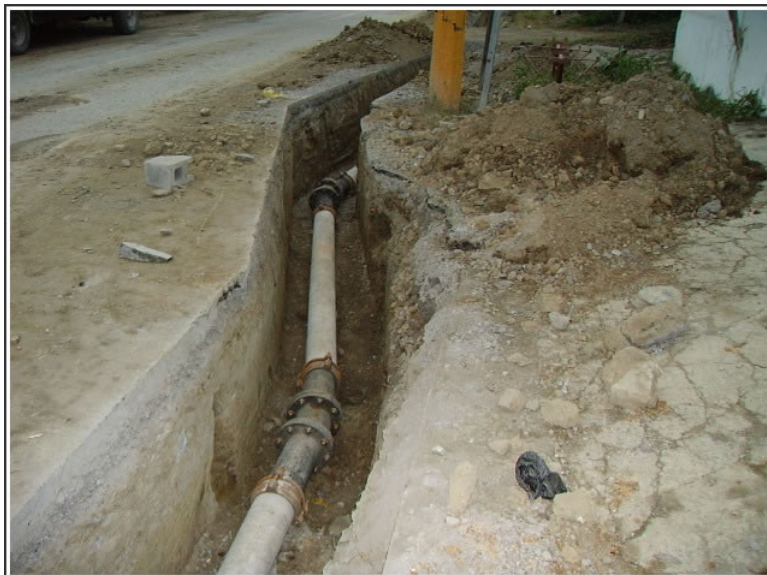
Figura C.1: Vista de la sustitución de tuberías en un tramo de red agua potable.
