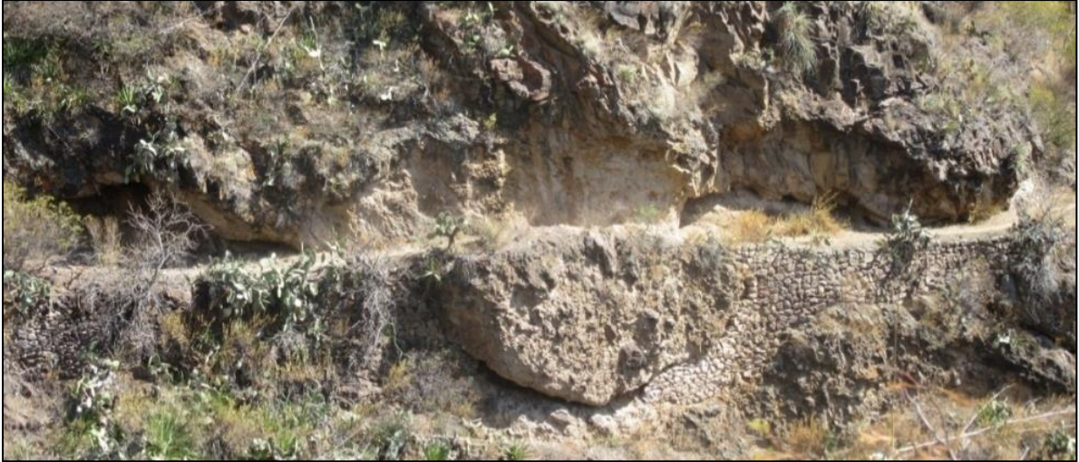
Fig. 17: Imagen del camino con corte en roca madre y muro de contención.
