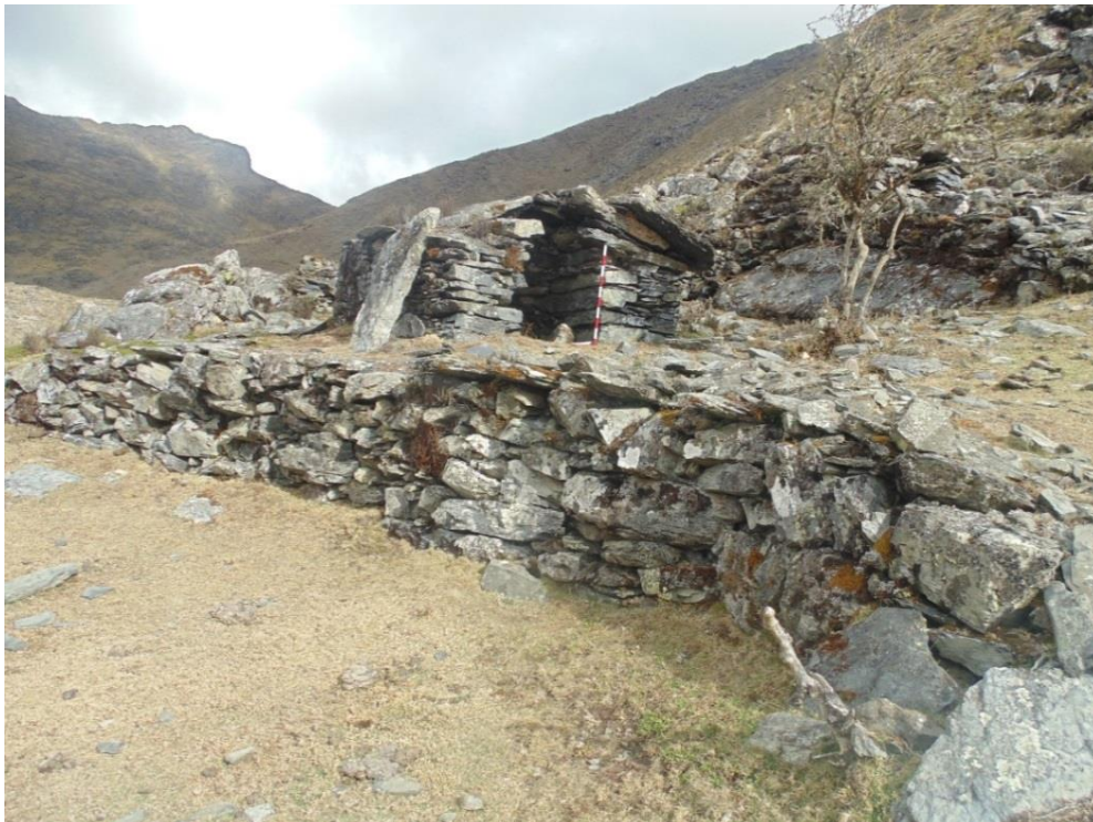
Figura 16: Muro de sostenimiento, construyeron para nivelar la geografía inclinada del terreno, formando la terraza artificial y encima construyeron la chullpa sin la necesidad de hacer zanja para su cimentación.
