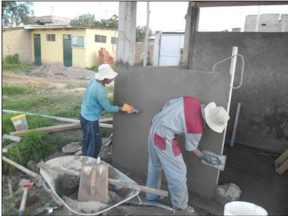
Fotografía 11. Recubrimiento del cabezal de riego
