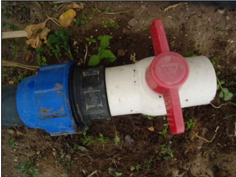
Fotografía 21. Válvula de control (PVC) en la red primaria
