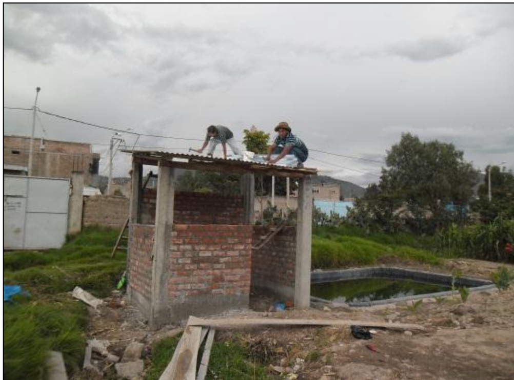
Fotografía 12. Techado del cabezal de riego
