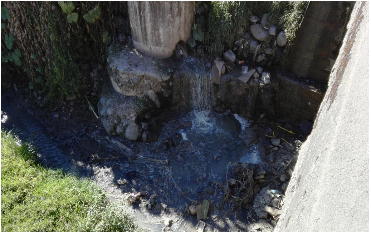
VISTA N° 06: VERTIDO DE AGUAS SERDAS DIRECTAMENTE AL RIO – DISTRITO DE TALAVERA
