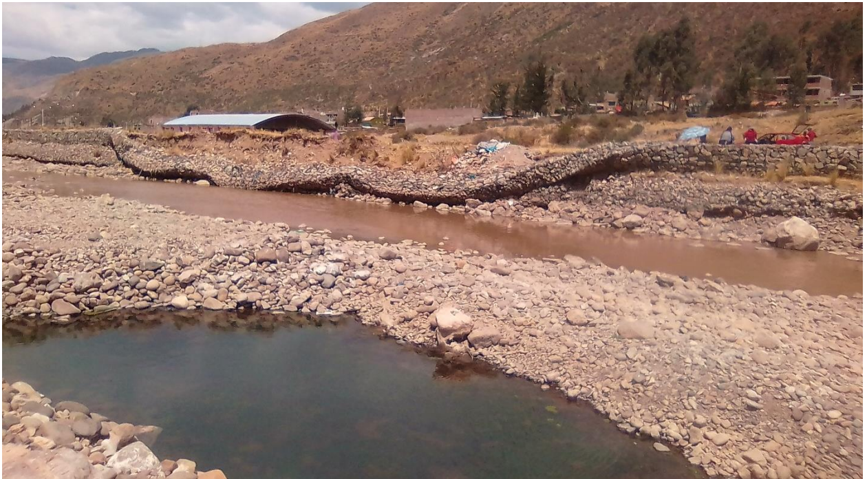
Figura B.7 Destrucción de gaviones por socavación, cauce del rio Ichu
