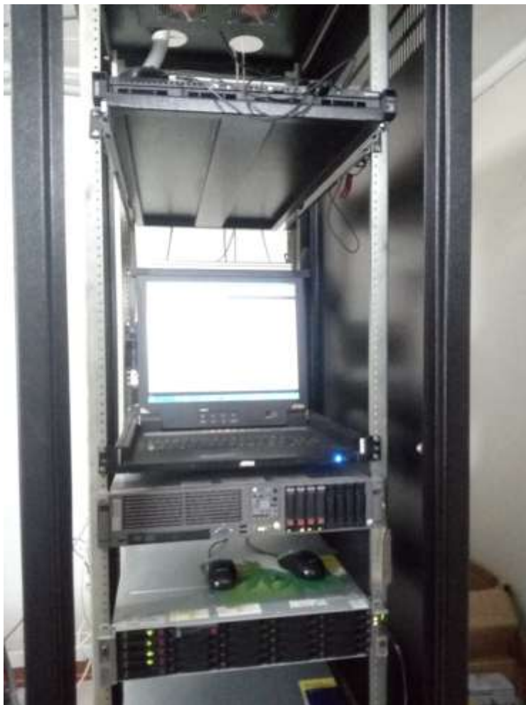
Ilustración F. 10 Vista frontal de Rack y servidores
