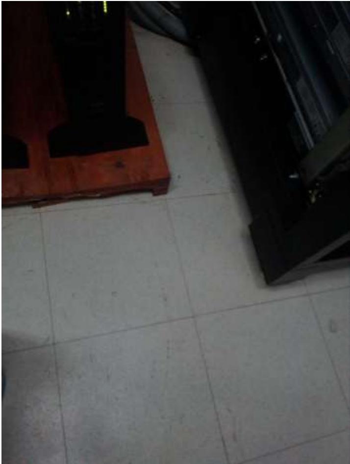
Ilustración F. 9 Piso Data Center
