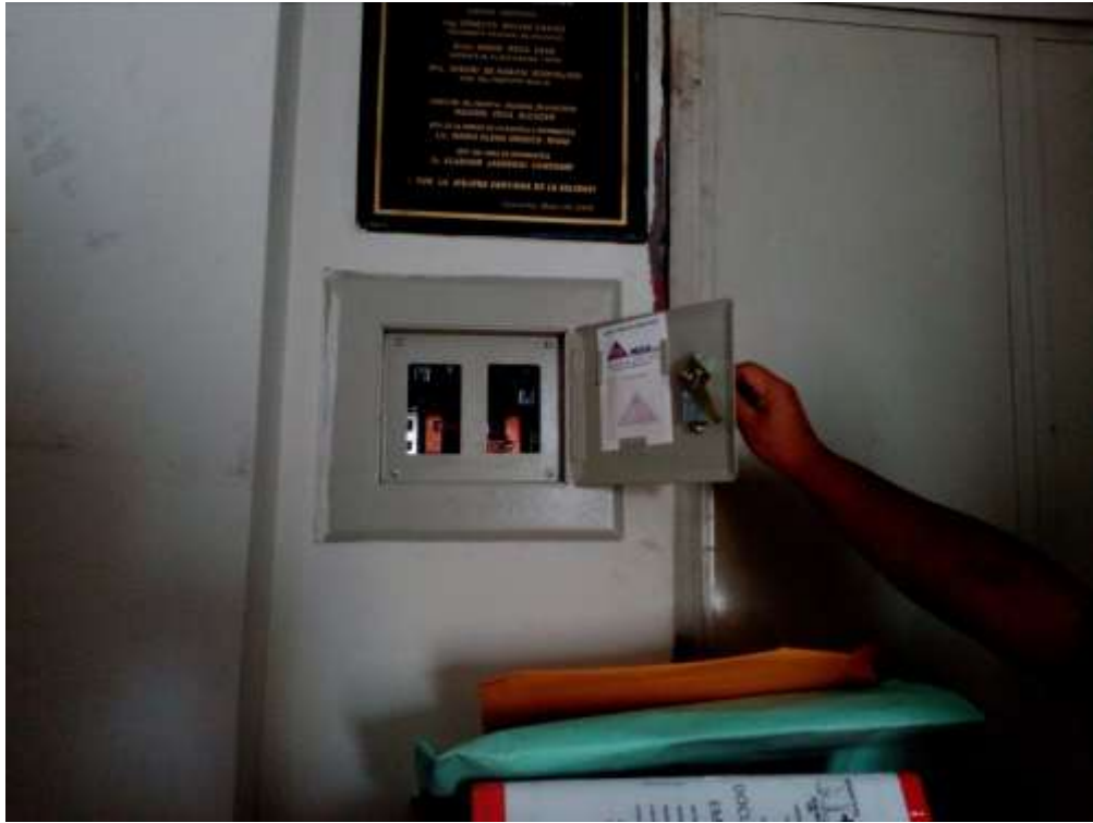
Ilustración F. 2 Tablero de distribución eléctrica
