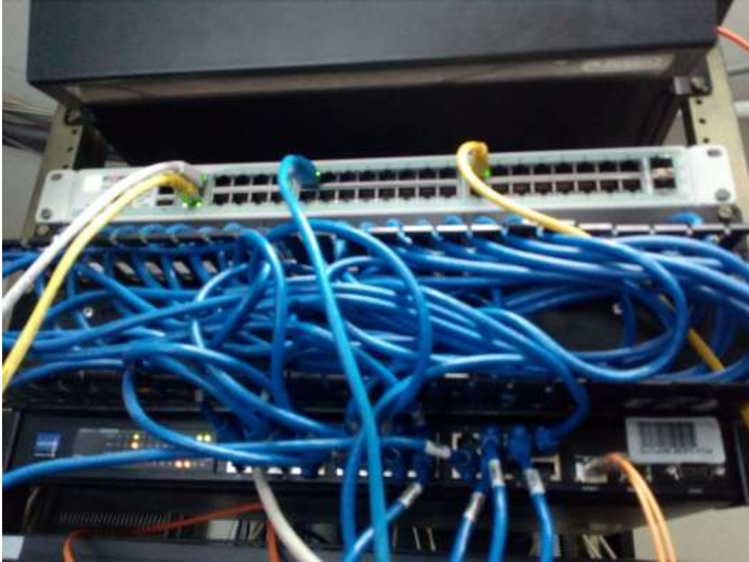
Ilustración F. 8 Cableado de servidores
