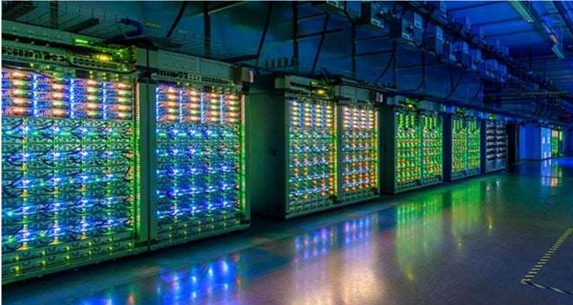
Figura N° 1 Data center de Google. (Google, 2018)
