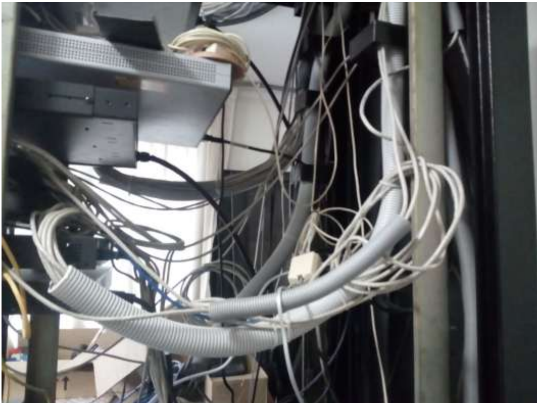
Ilustración F. 7 cableado del Rack
