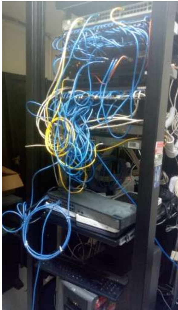
Ilustración F. 13 Vista parte posterior de cableado del rack
