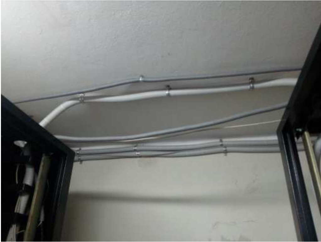
Ilustración F. 6 Cableado interior del ambiente
