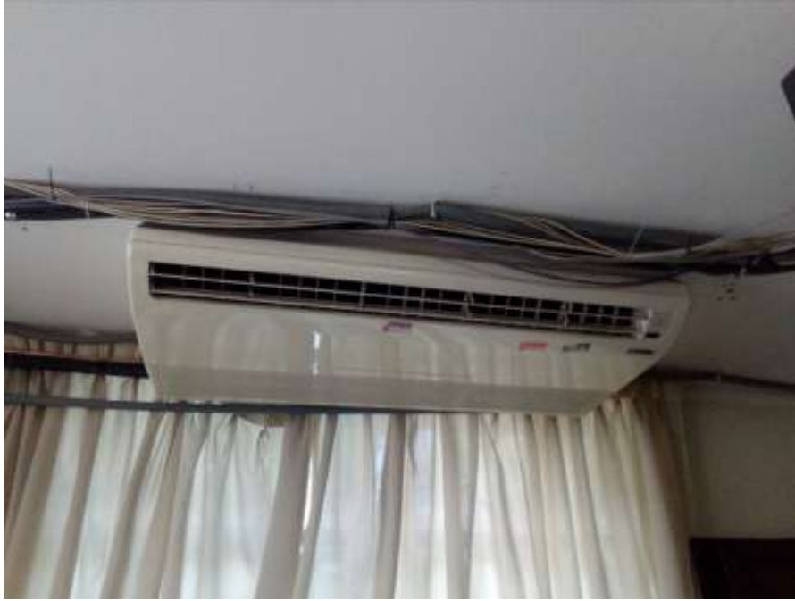
Ilustración F. 12 Aire acondiciona
