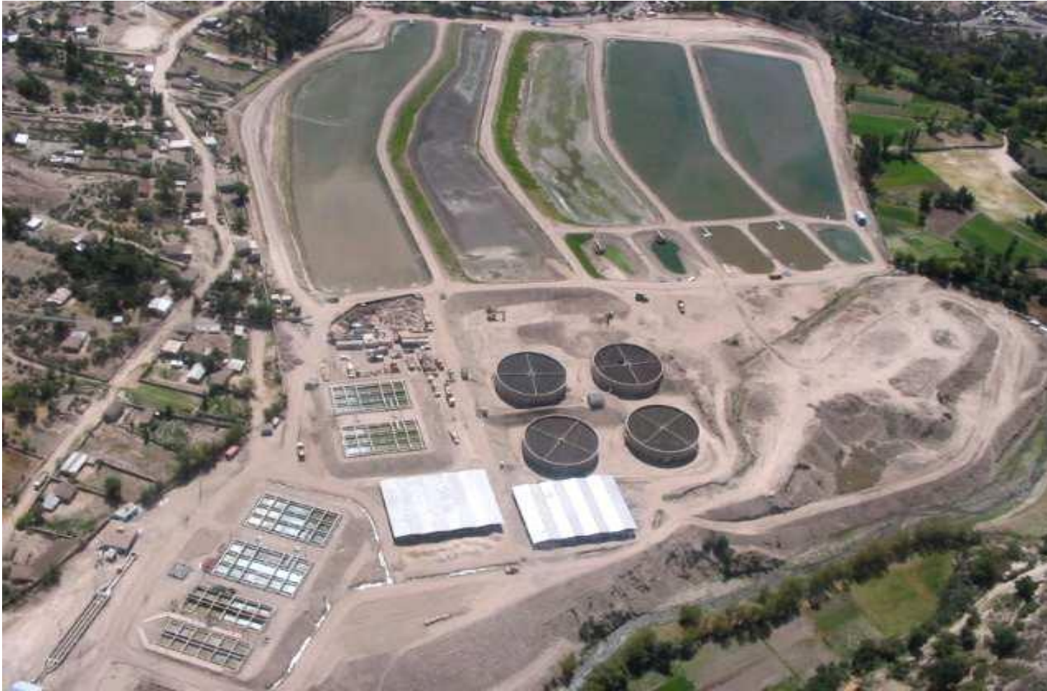
Anexo 19. Vista panorámica de la planta de tratamiento de aguas residuales Totora, Ayacucho 2014.
