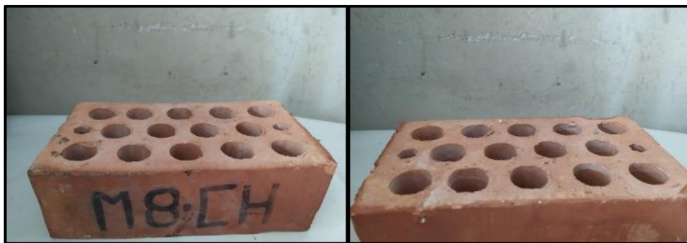
Figura 2.28. Unidades con una ligera eflorescencia
