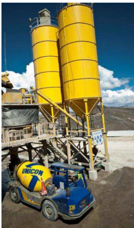
Figura 26: Planta de Preparación de Concreto
