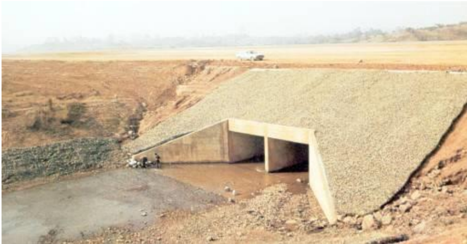
Figura 1.7 Alcantarillas Cajón bajo un fuerte relleno
