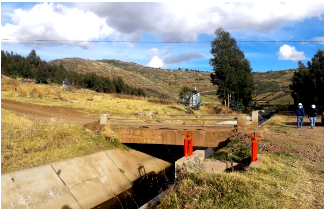
Figura A.3: Canal trapezoidal la compuerta de toma lateral y pase vehicular
