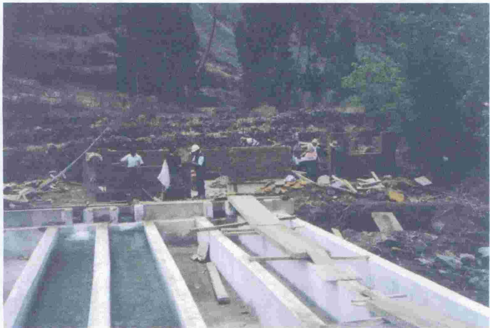
Fotog. 3 Beneficiarios del proyecto construyendo los ambientes administrativos y almacén de la piscigranja
