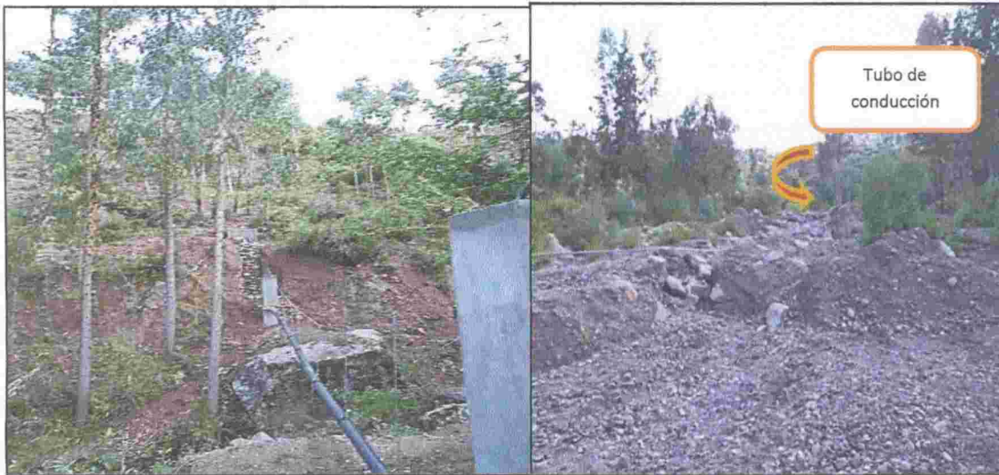
Figura 15. Vista panorámica del sistema de conducción del servicio de agua entubada en la comunidad de Accomarca, octubre del 2012.
