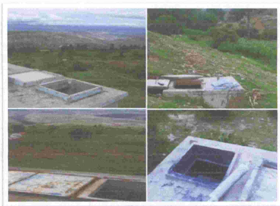
Figura 14. Reservorios en mal estado de las comunidades de Lucaspata, Huamancchocha, Ccacce y Pamparque, noviembre del 2012.
