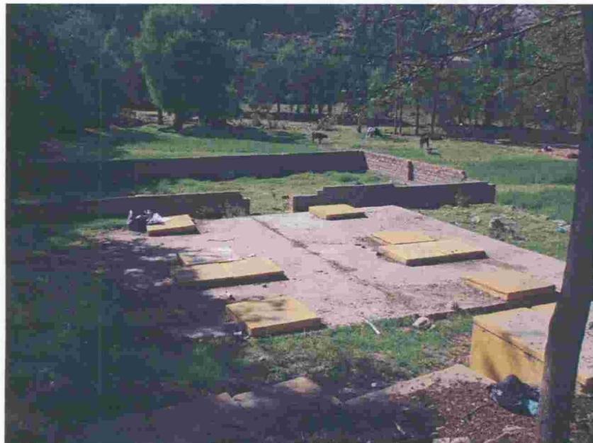
Fotografía N° 04: Pozos sépticos del distrito de Pacaycasa – Romasa. Noviembre de 2011.
