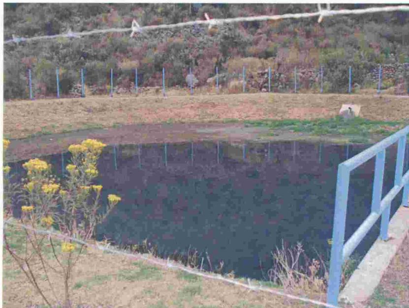
Fotografía N° 08: Laguna N° 02 de la Planta de Tratamiento de Aguas Residuales del distrito de Vinchos. Setiembre del 2012.
