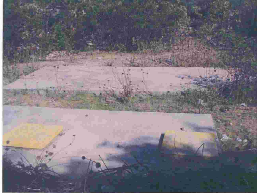
Fotografía N° 05: Pozos sépticos del distrito de Pacaycasa. Setiembre del 2011.
