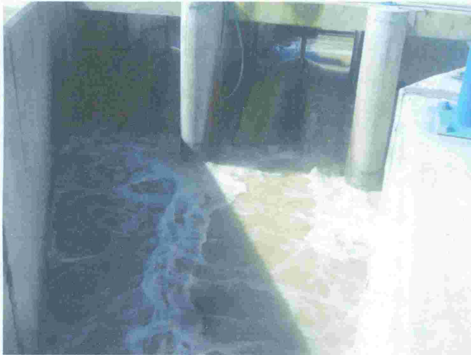
Fotografía N° 01: Afluente de la Planta de Tratamiento de Aguas Residuales "La Titora" 2010.
