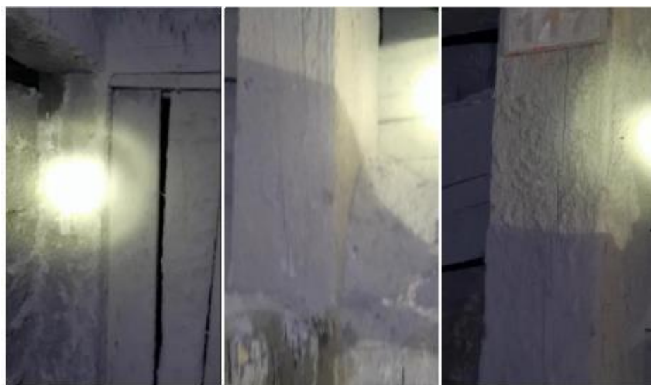
Figura 31. Cuadros deteriorados por el tiempo y uso (hasta Cdros 118).
