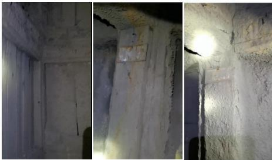
Figura 32. Cuadros deteriorados por el tiempo y uso desde el Nivel 465 al 520.
