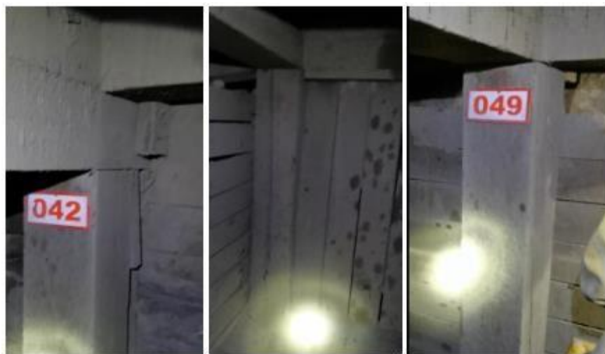
Figura 26. No se observa deformación salvo rajaduras en los postes de los cuadros del pique.
