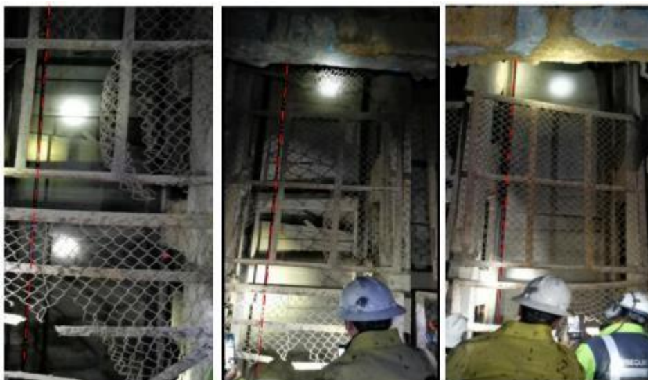
Figura 33. En el nivel 520 Se verificó la ubicación de los cables cuando la jaula está en el nivel cero y el skip en nivel en 970.
