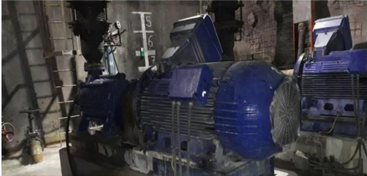
Figura 10: Bombas estacionarias del Nv 11 - 450 HP c/u
