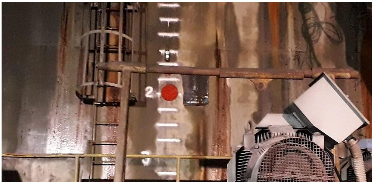
Figura 12: Punto de monitoreo – Estación de bombeo Nv. 10
