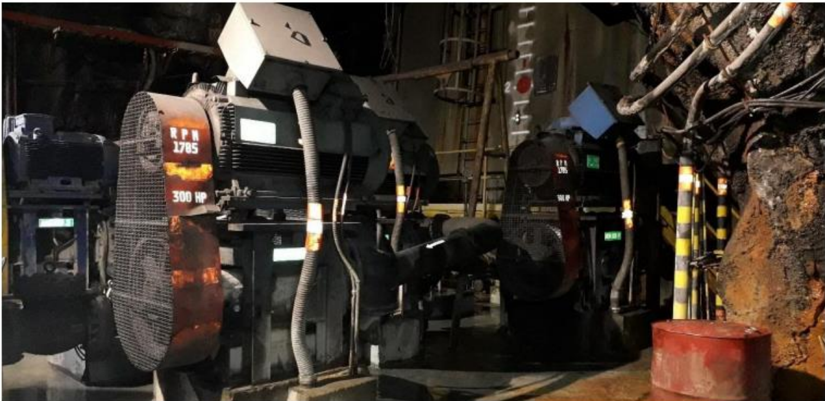
Figura 8: Trenes de bombas
