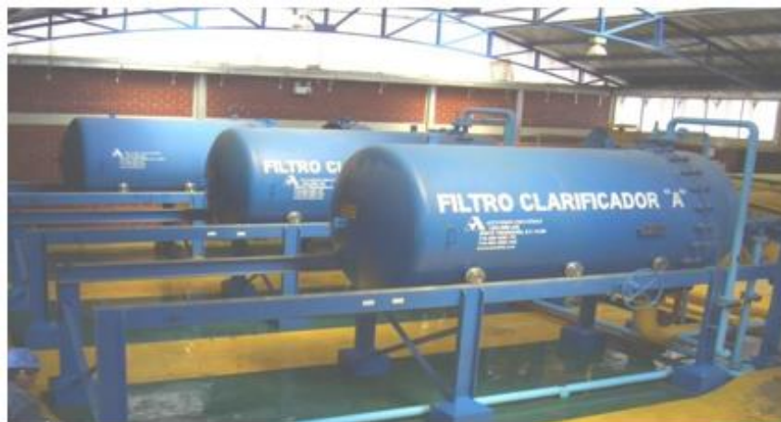
Figura 20. Filtros clarificadores con área de 1200 ft 2 por unidad
