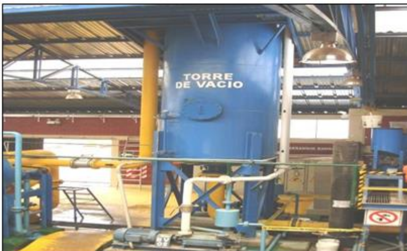
Figura 21. Torre de vacío en la planta Merrill Crowe
