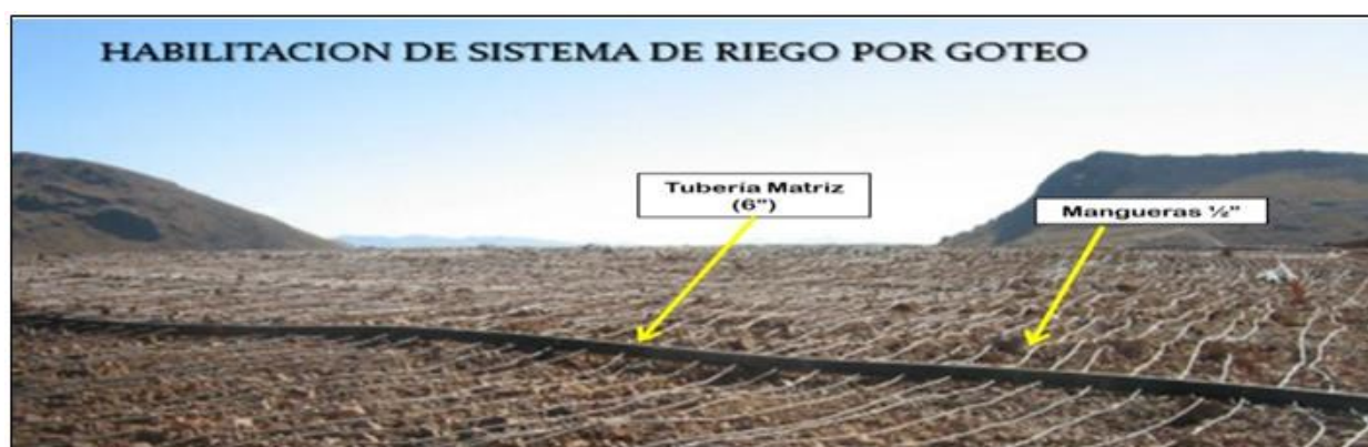
Figura 17. Sistema de tuberías para riego de mineral
