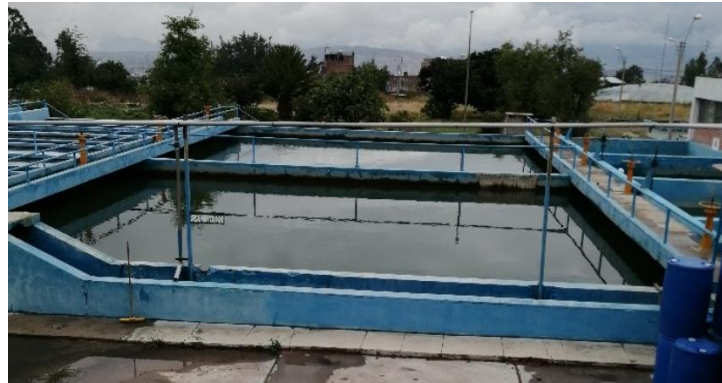
Sedimentadores de la Planta 1 – PTAP Quicapata
