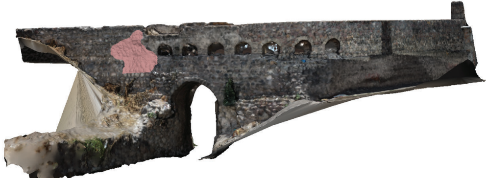
Figura 4.19: Fallas en el puente Sutuq Chaca.
