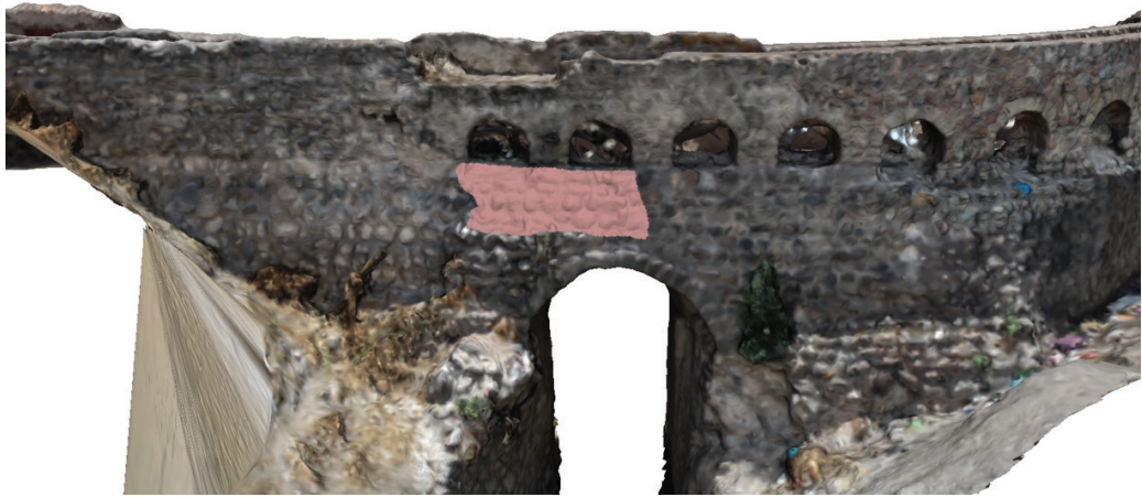
Figura 4.21: Vista de la falla del puente Sutuy Chaca.
