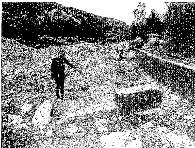
Figura 6.24: Parte de bocatoma Mayzondo, colapsada
