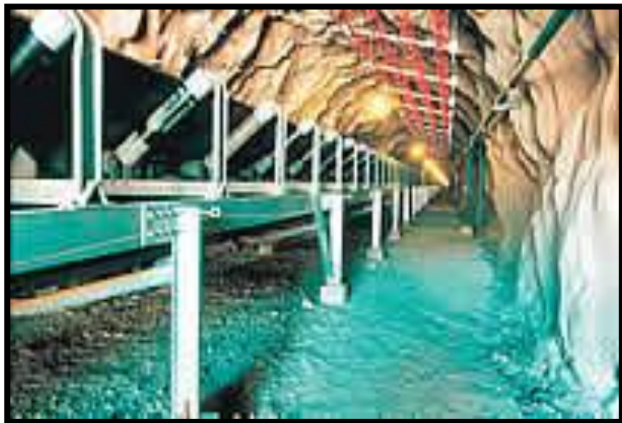
Figura 9: Representación fotográfica de instalaciones para transporte mediante fajas.
