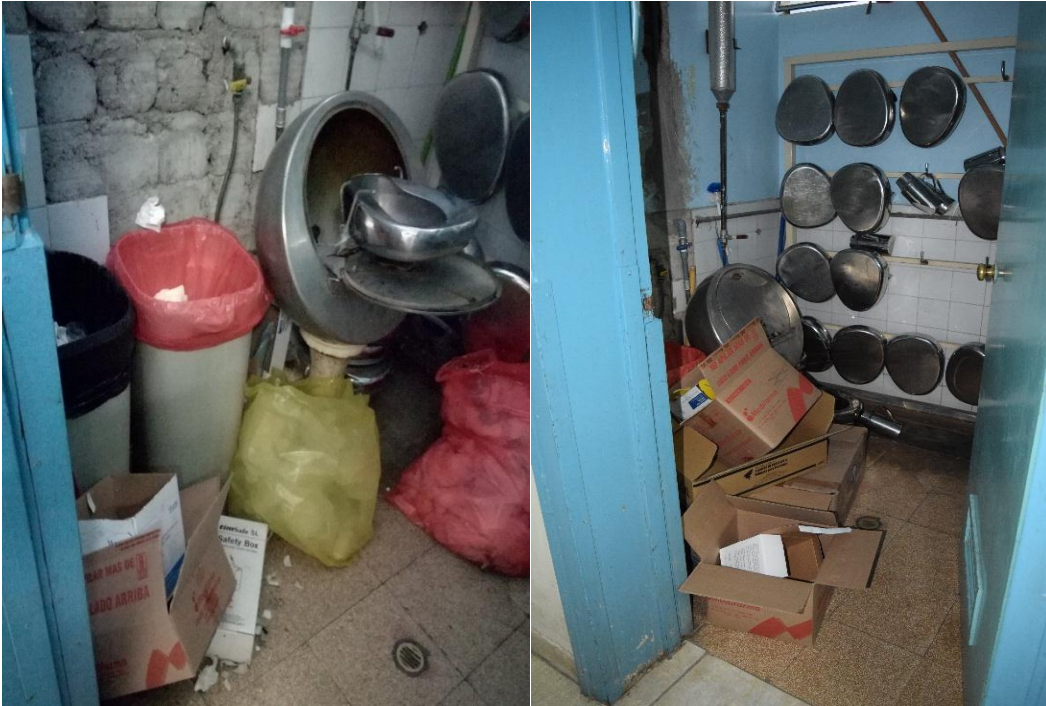
Fotografía 14. inadecuado almacenamiento intermedio de los residuos hospitalarios. (área no cumple los estándares).
