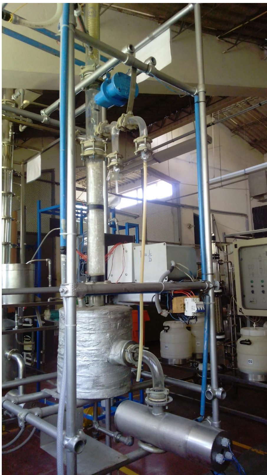
Equipo de destilación batch con rectificación, vista posterior
