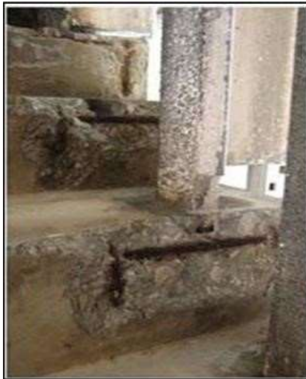
Figura 2.4: Efectos en el hormigón (Paredes et al. 2008).
