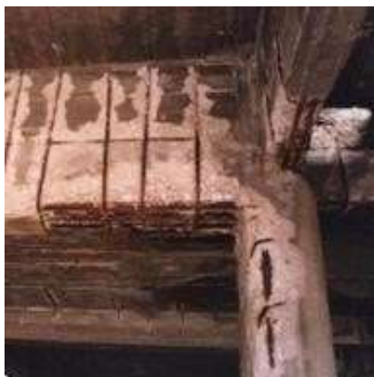
Figura 2.6: Efectos en el sistema hormigón armado (Paredes et al. 2008).
