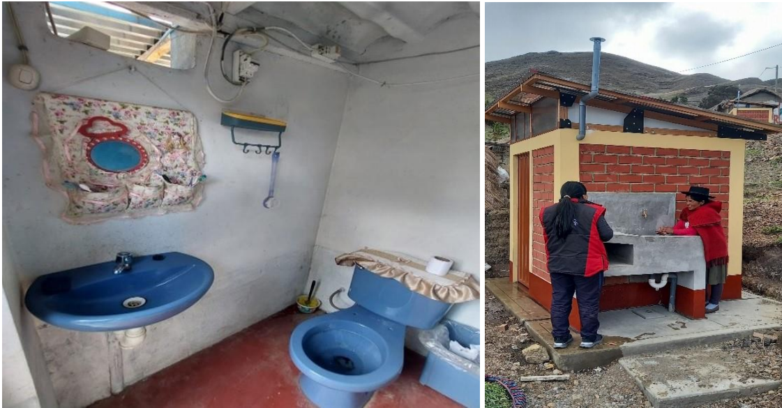
Fotografía 4. Unidad básica instalada en la comunidad de Tanahuasi
