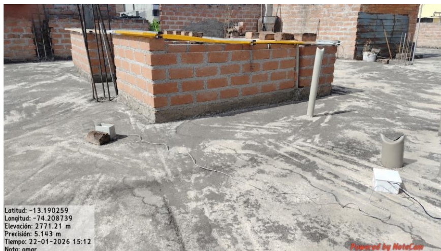
Fotografía 27. Instalación de pluviómetro y módulo de adquisición en estación de monitoreo Omar
