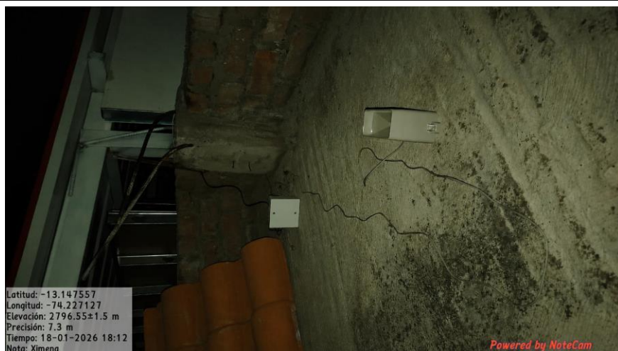
Fotografía 17. Instalación de estación de monitoreo Ximena.
