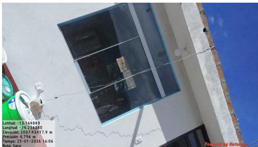
Fotografía 19. Instalación de estación de monitoreo Sara.
