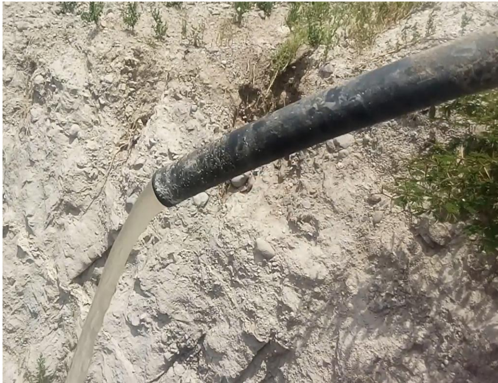
Foto 17: Funcionamiento del sistema de bombeo
