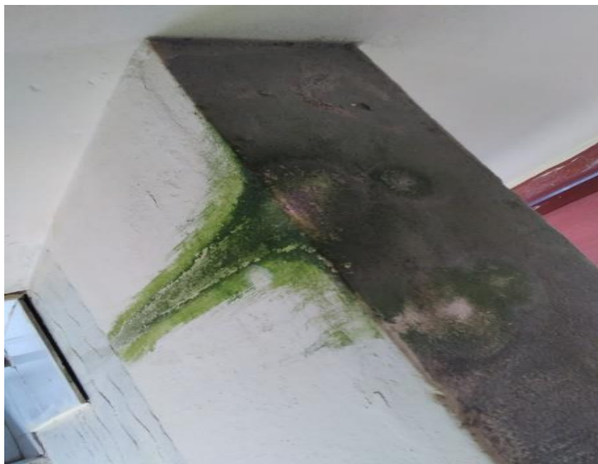
Figura 17. Infraestructura educativa corroída por la filtración de agua.
