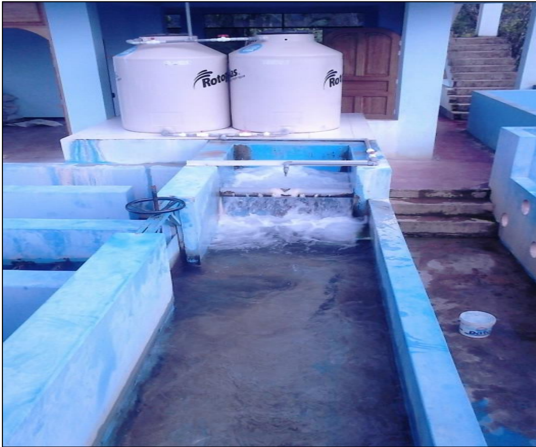
Figura 12. Canaleta Parshall en la Planta de Tratamiento de Agua Potable de Ayna–San Francisco
