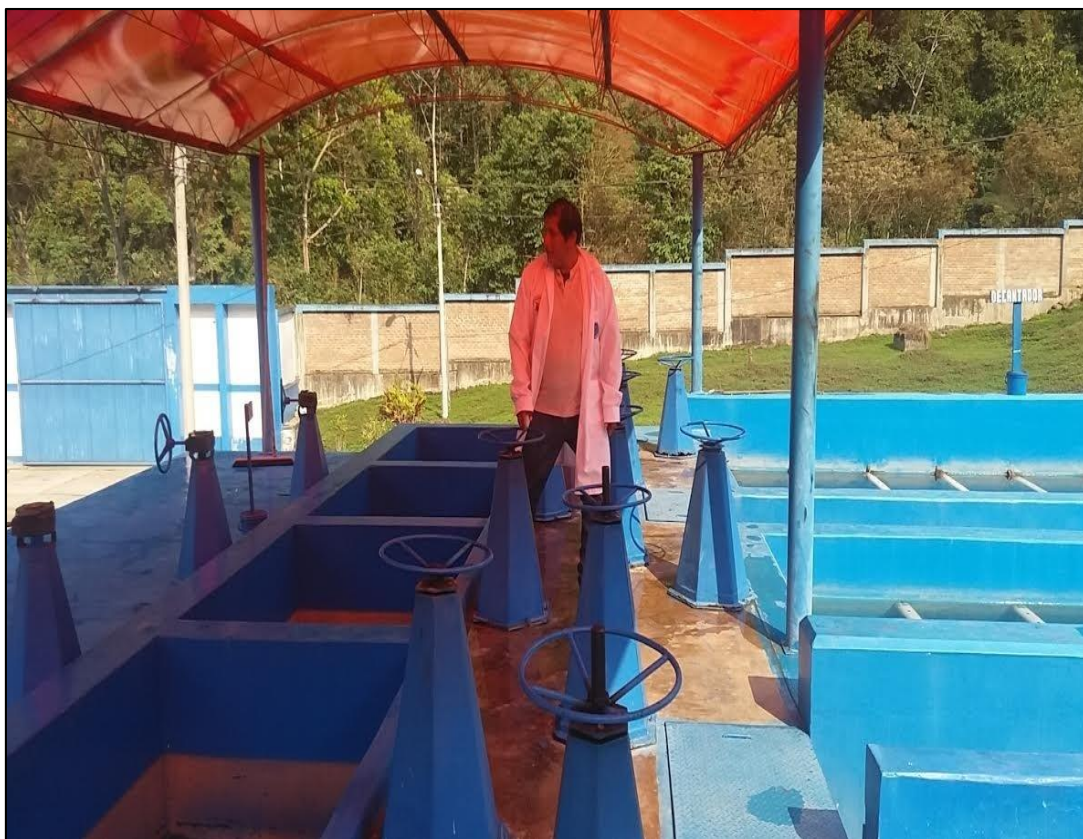
Figura 5. Centro de control de apertura y cierre de filtros
