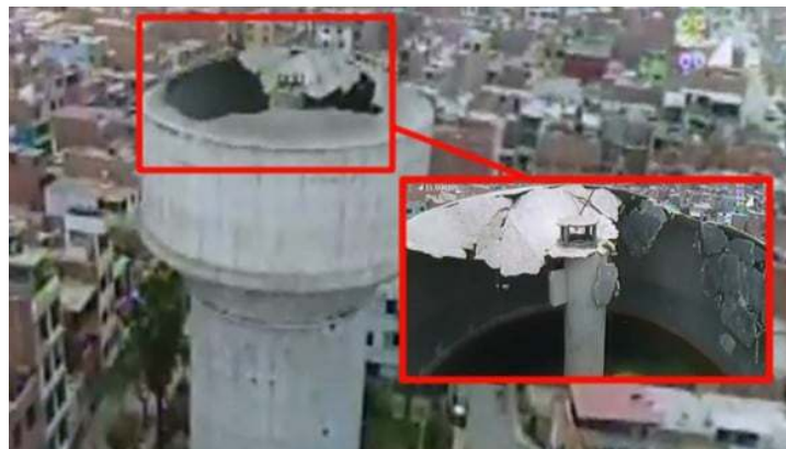
Fig. 12 Tanque elevado con fuste deteriorado (Callao – Lima).
