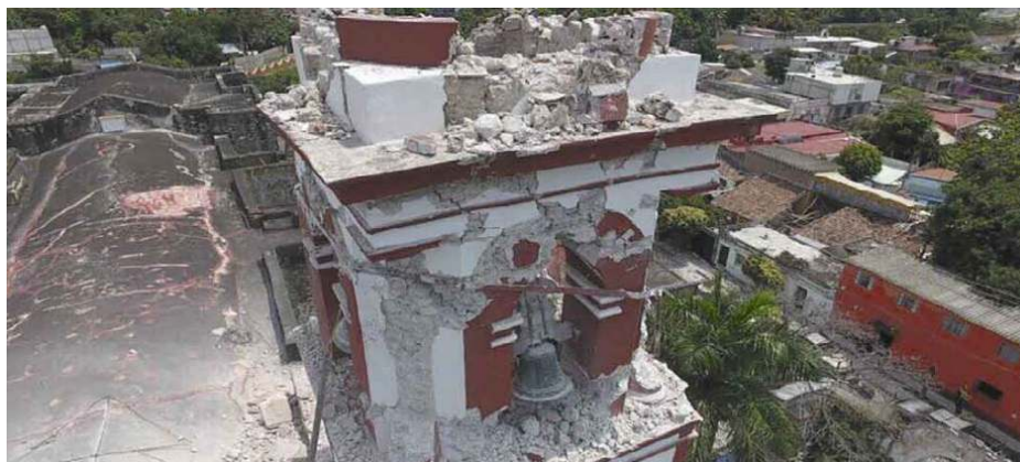
Fig. 8 Estado situacional del templo post Terremoto.
