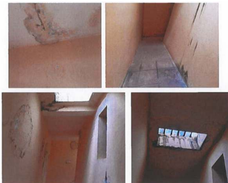
Fig. 18 Vista del estado situacional del interior del obelisco en diferentes niveles.
