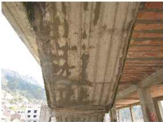
(a) Fisuras transversales en el tramo medio de la escalera
