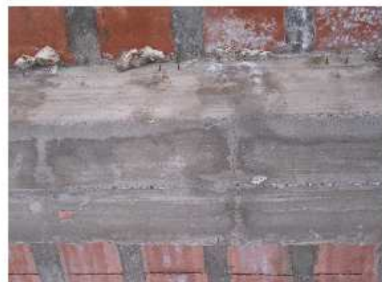
(b) Fisuras en el tramo medio de las vigas. Sec. 50cm x 70cm, 3er piso
