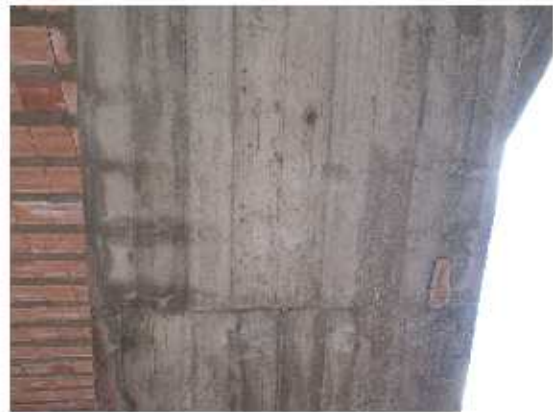
(b) Fisuras transversales en el tramo medio de la escalera
