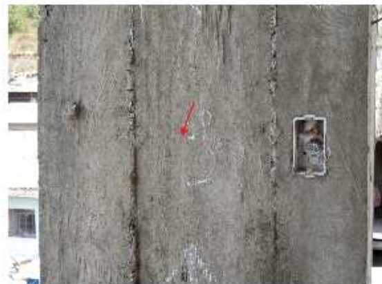
(b) Fisuras en todo lo ancho y a media altura de la columna
