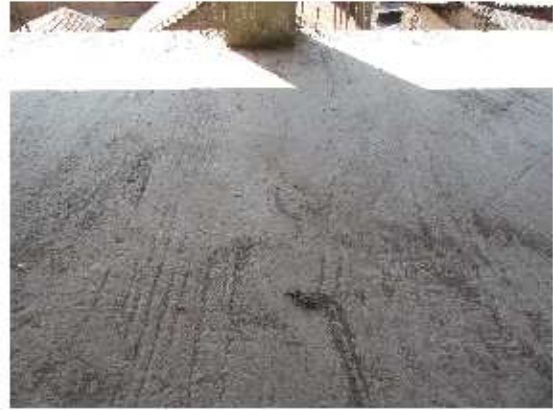
(b) Fisuras longitudinales en la dirección de las vigas
