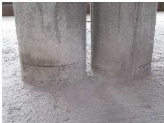
(a) Exposición de estribos y "cangregeras" en la base de la columnas
