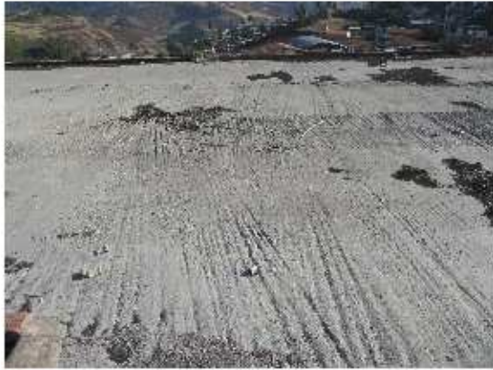
(a) Fisuras longitudinales en la losa, en la dirección de las vigas
