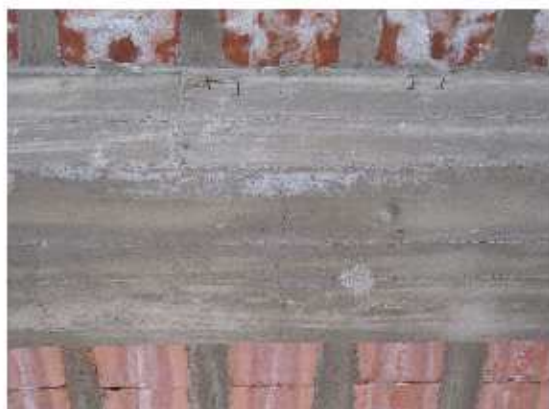
(a) Fisuras en el tramo medio de las vigas. Sec. 50cm x 70cm, 2do piso
