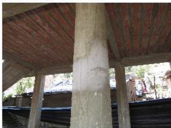
(c) Resanes echos a media altura de las columnas
