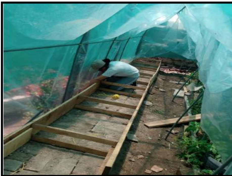
Figura 1. Instalación de contenedores de madera para el sistema hidropónica raíz flotante.
