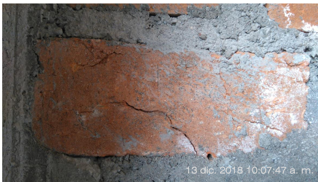
Figura 1 Fisura en la unidad de albañilería.
