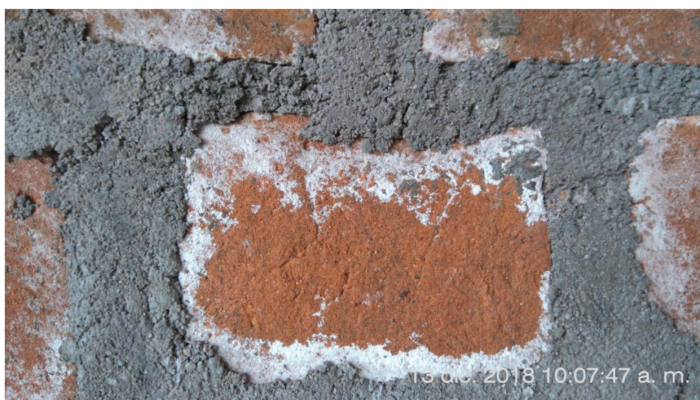
Figura 2 Eflorescencia en la unidad de albañilería.
