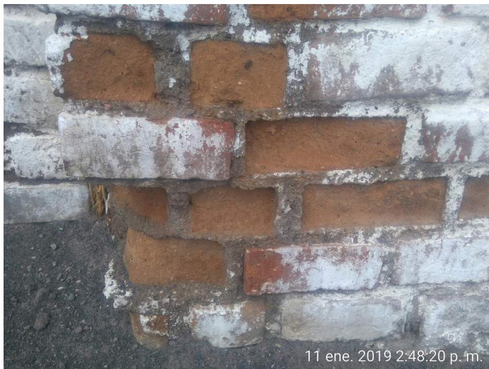
Figura 4 Daños en las unidades de albañilería. Fuente: Elaboración propia
